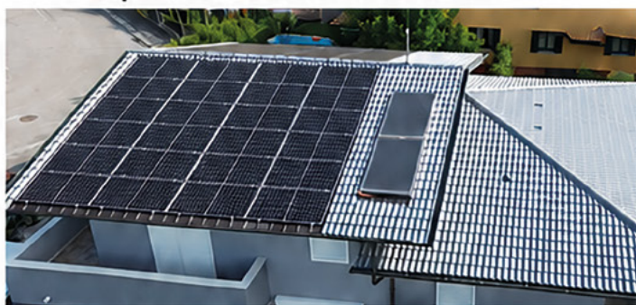
Nuovo impianto fotovoltaico casa singola
