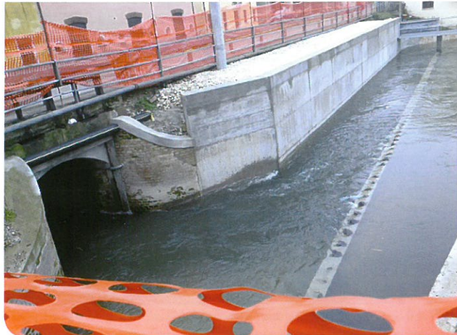
Scolmatore Ceresone ad Arlesega - 2013
